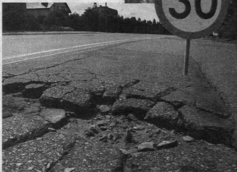
Niedługo po tych koszmarnych dziurach na Sandomierskiej pozostanie tylko wspomnienie
